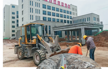
春潮涌动，万物竞发。产教融合科技园项目施工单位以项目建设为契机，抢抓春季施工黄金期，紧盯目标任务，鼓足干劲、不负春光，奋力拼出项目建设新速度。
